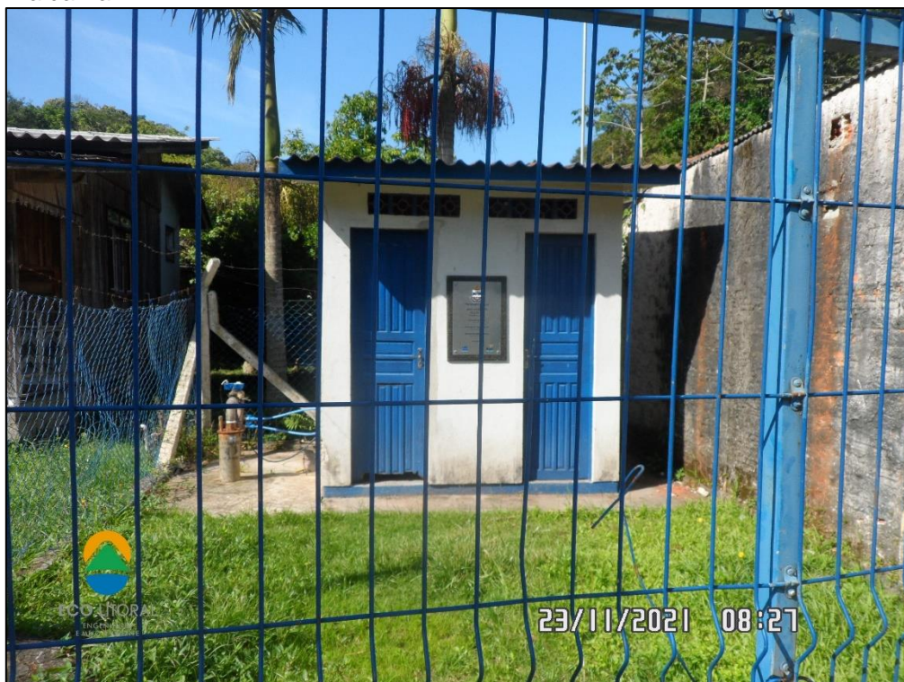
Figura 24 - Poço artesiano da SEMASA que distribui água para toda a Comunidade Vila da Paz.
