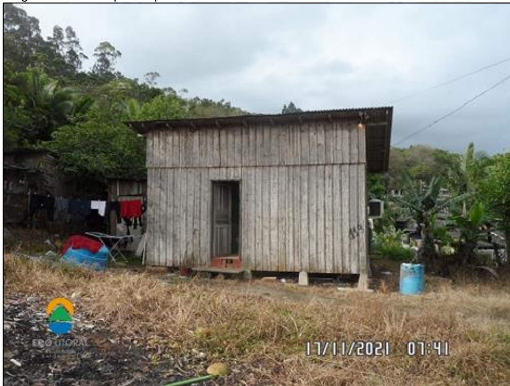
Figura 34 - Exemplo do padrão construtivo de uma residência do Setor D.
